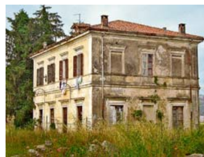
Anche la stazione di Sossano è in stato di abbandono. FOTO MILANI
